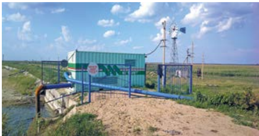
Фото 1. Автоматическая контейнерная насосная станция ШН-КЕЛЕТ на объекте
