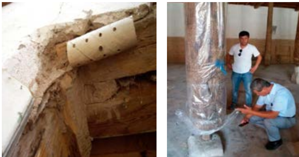
Рисунок 2. Установка противотермитных приманок - а).в жилых помещениях. б).В историческом комплексе «Ичан-Калъа» – на колоннах мечети «Джума»
