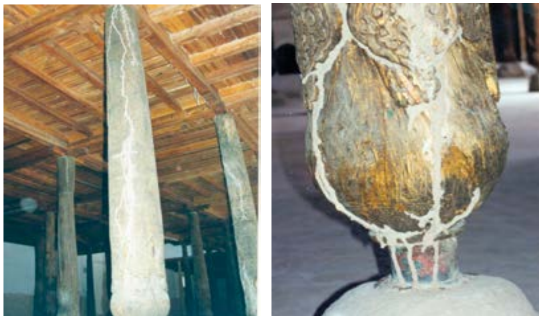
Рисунок 1. Повреждения термитами древесных конструкций мечети «Джума» в историческом комплексе Ичан-Калъа г. Хива, Узбекистан.
